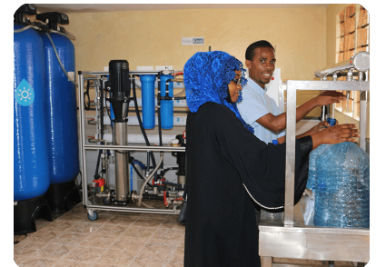
Solarbetriebene Wasseraufbereitung in Kenia
